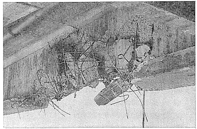
写真-3 破損側復部の状況（内側）
