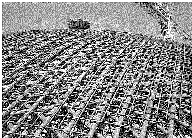
写真-4 ドームダクト配置状況
