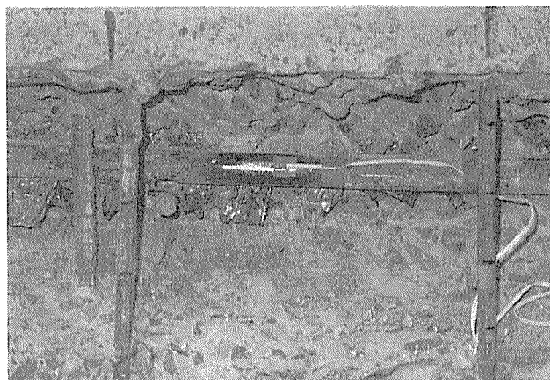
写真-2 はつり出した PC 鋼棒の状態
