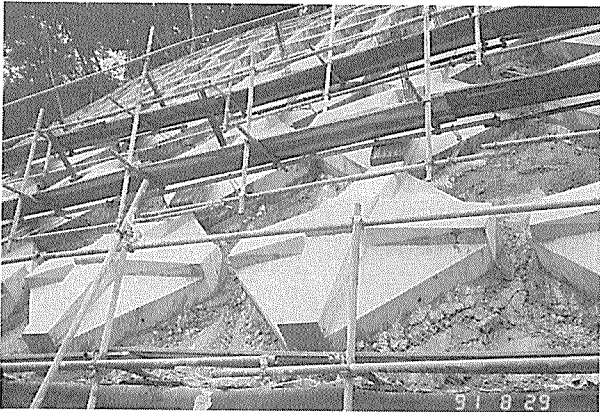
写真-4 セミスクエタイプ施工例 工事件名：付替町道万沢線四万工区道路改良工事 工事場所：群馬県吾妻郡中之条町 製品規格：SS 250-55
