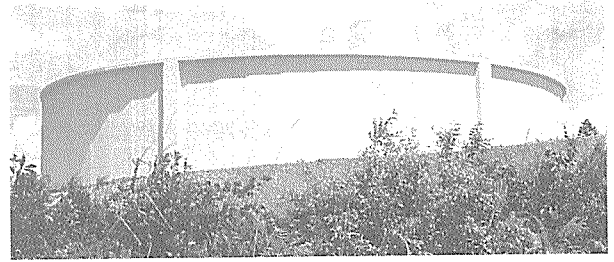
写真-6 牧ノ原 6000tタンク
