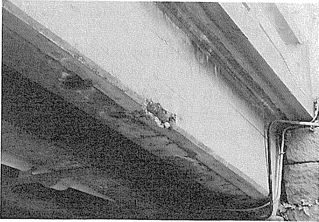
写真-2 旧北桔橋損傷状況
