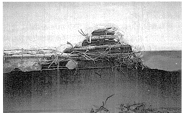
写真-3 損傷状況 (P 102～P 103, 耳桁 (G 1))
