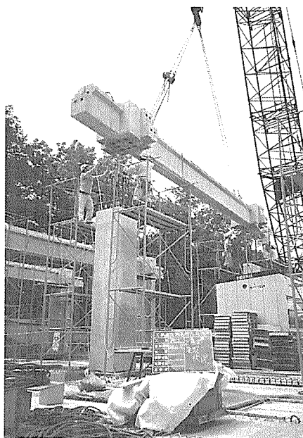
写真-4 スパン方向大梁架設
