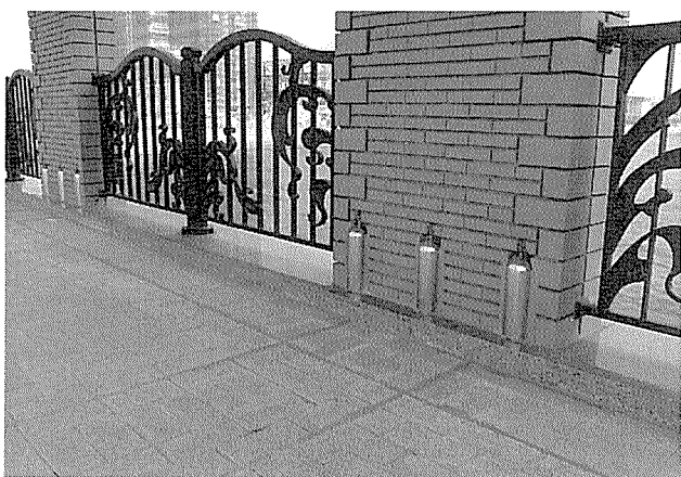
写真-10 自動洗浄設備
