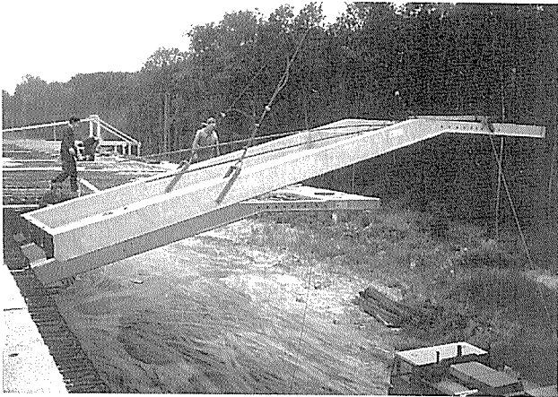
写真-4 端部をリブで補強したスラブ形式のプレキャストストラットの設置状況
