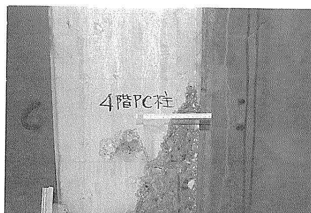
写真-15 4階 PC 柱の中性化 殆ど無し
