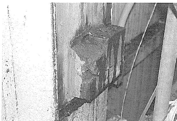
写真-12 PC 鋼棒定着部保護健全部の中性化
