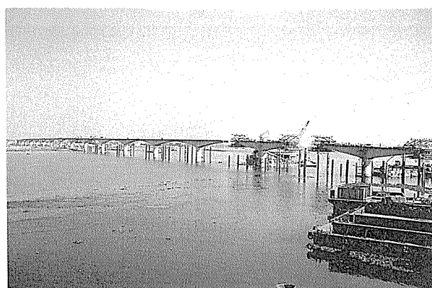
写真-18 施工中のメグナ・グムチ橋（新アジア・ハイウェイ・ルート A-41）（橋長1410m）〔提供：大林組〕
