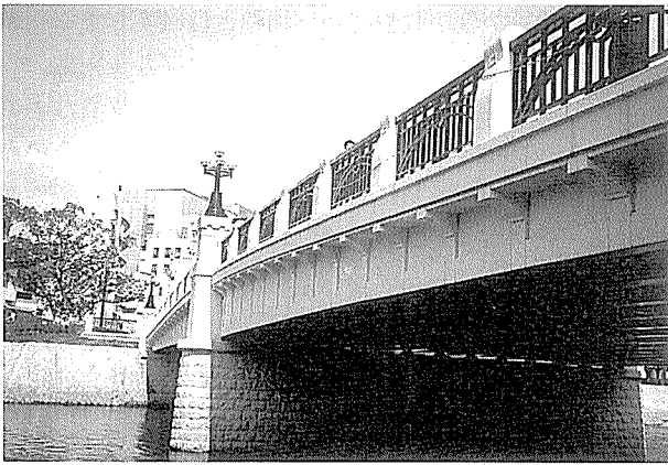
写真-9 元安橋・広島 どこからみても鋼桁橋に石橋のイメージの化粧が施されている。周辺景観や歴史性への配慮は大切だが、それをどう表現するかが問題である。
