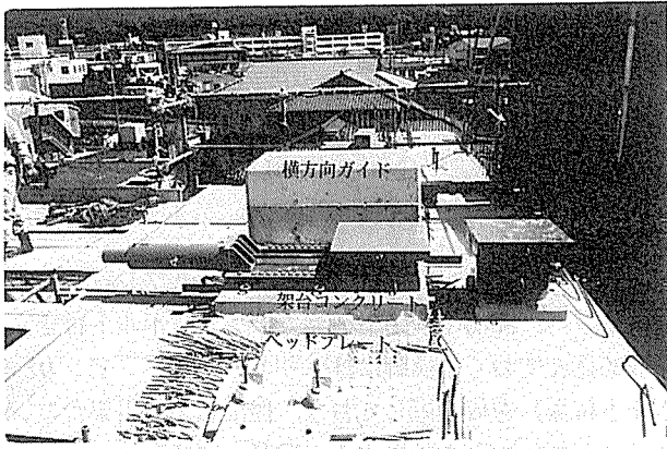
写真-5 横方向ガイドコンクリートブロック
