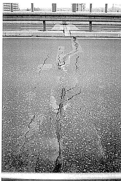
写真-3 伸縮ジョイント損傷
