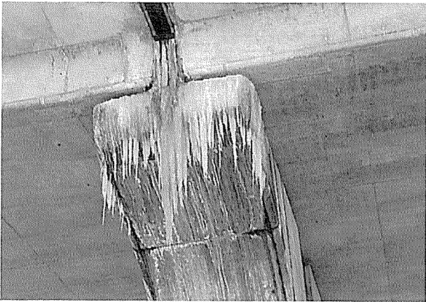
写真-4 国道上にせり出したつらら
