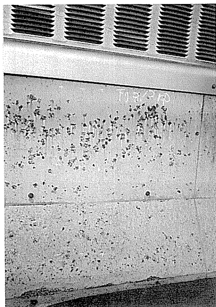
写真-2 壁高欄の凍塩害による複合劣化
