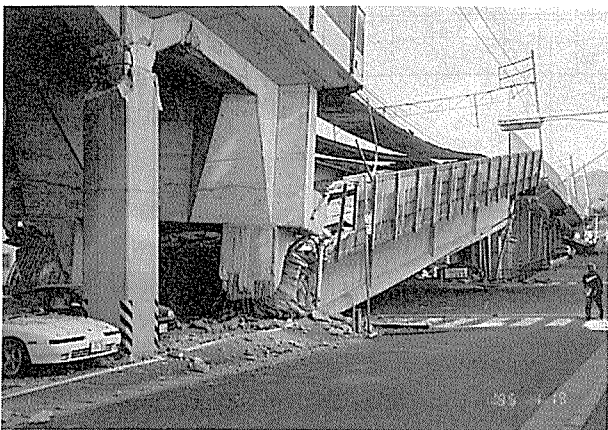
写真-4 被災状況
