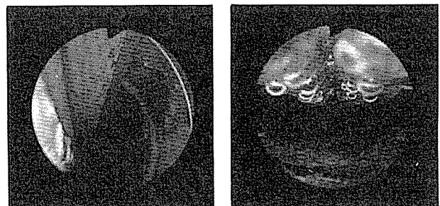
(a) PC鋼材が錆びている (b) PC鋼材に結露が付着している
