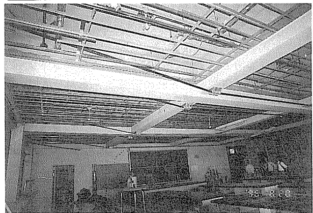
写真-5 梁補強アウトケーブル
