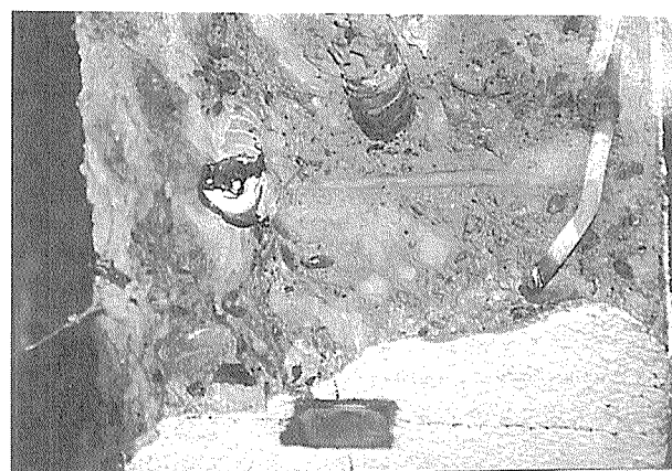
写真-7 (A) PCa. PC梁の中性化試験
