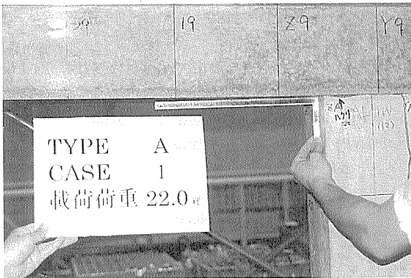
写真-3 外側ストラットの変形
