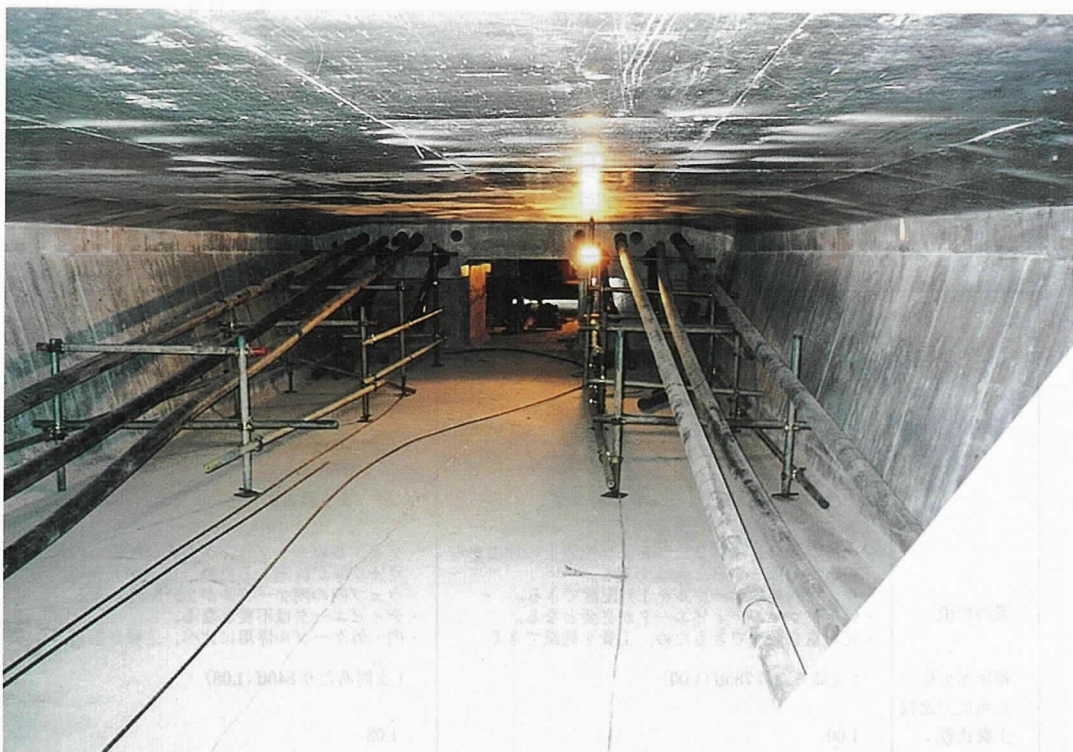
写真-3 外ケーブル配置
