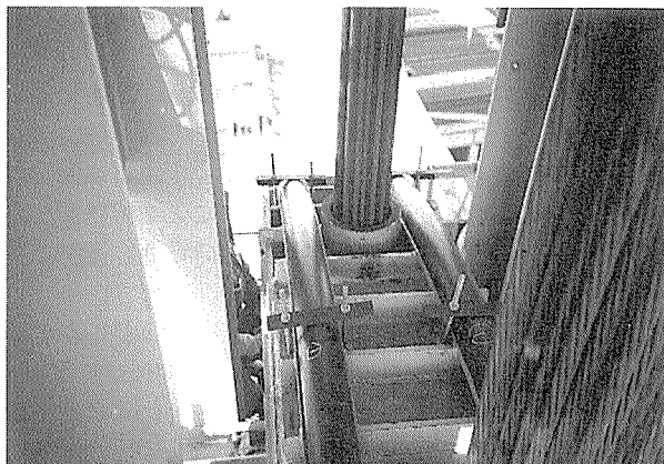
写真-10 仮設斜ケーブル・サドル・吊り鋼材の取付け状況
