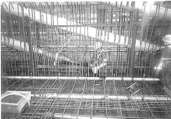
写真-4 ベント管
