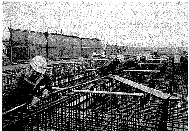
写真-2 ケーブル配置状況
