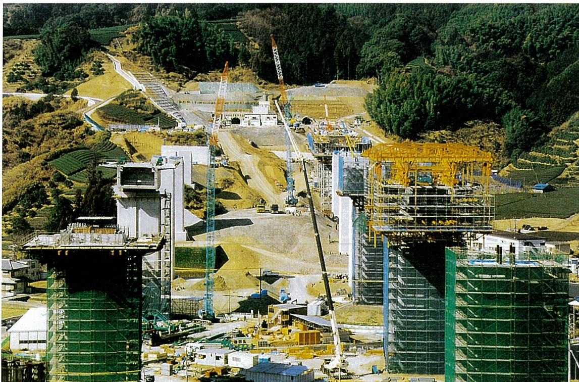
写真-1 第二東名静岡県初の上部工架設 瀬戸川橋(PC上部工)工事 (写真提供：日本道路公団 静岡建設局 静岡工事事務所)
