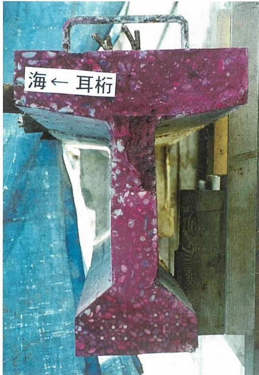
写真-2 桁の中性化状況
