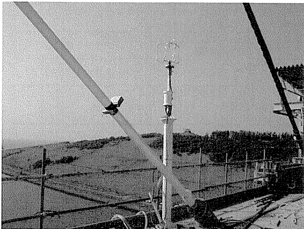
写真-12 超音波式風速計および斜材風振動計測器(内灘大橋)
