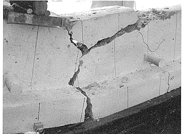
写真 - 6 PC の破壊状況 (S-2 桁)
