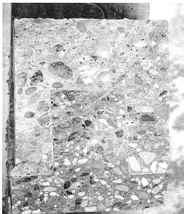
写真 - 3 桁の中性化状況
