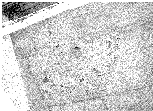
写真-1 PC 鋼棒突出によるコンクリート押抜きあと
