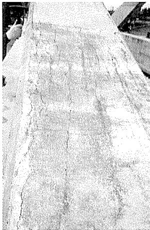
写真-2 アルカリ骨材反応による変状
