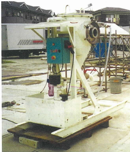
写真 - 2 真空ポンプユニット
