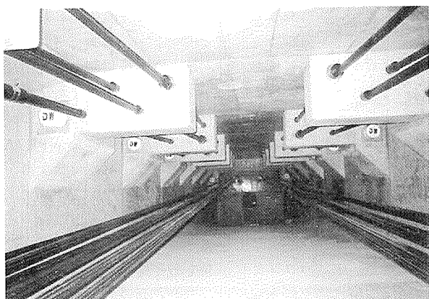
写真 - 2 外ケーブル配置
