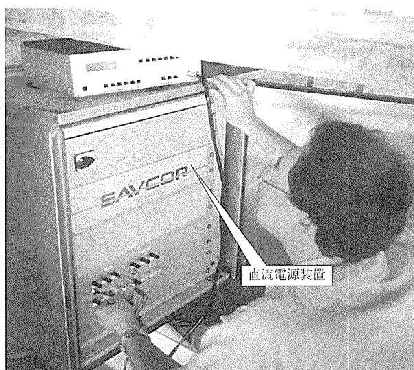
写真 - 4 直流電源装置と測定状況
