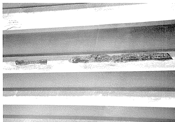
写真-8 従来補修工法箇所状況（施工7年後）
