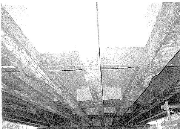
写真-6 損傷状況
