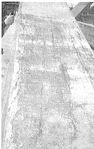
写真 - 4 アルカリ骨材反応によるひび割れ
