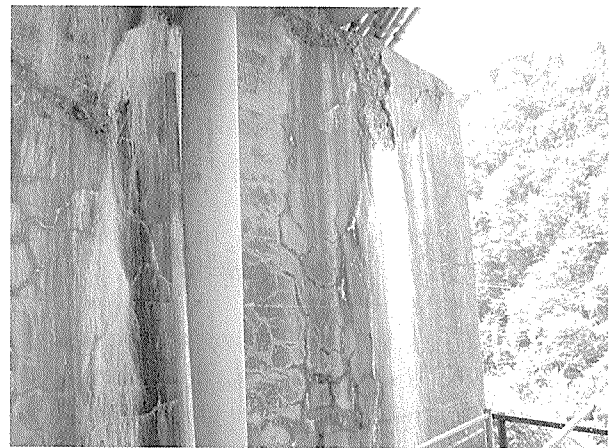
写真-3 水仕舞いの問題例（アル骨と凍害を受けた橋台）
