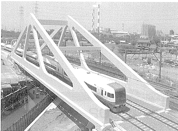
写真-8 内房線姉ヶ崎橋梁
