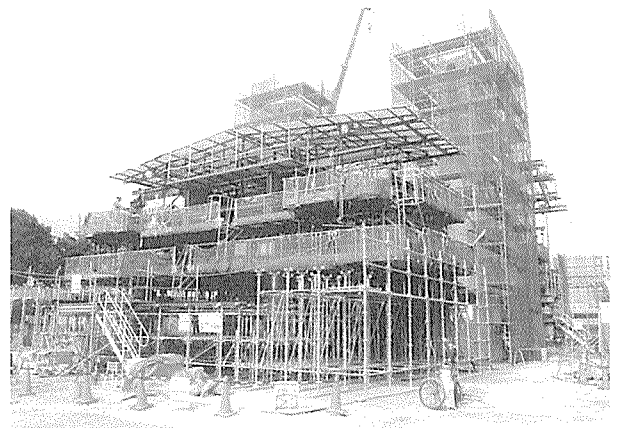
写真-3 移動型枠設備全景
