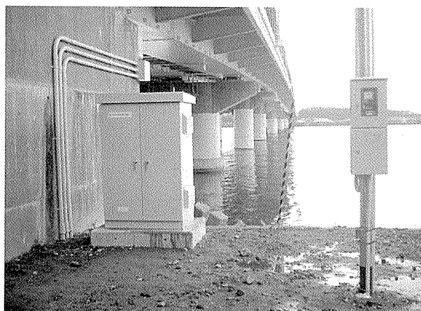
写真 - 14 直流電源装置
