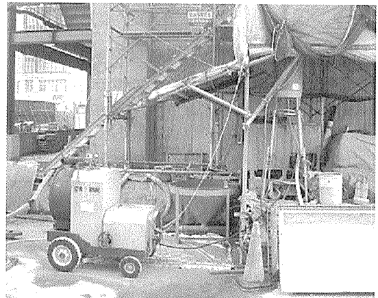
写真 - 14 グラウトプラント (1階)
