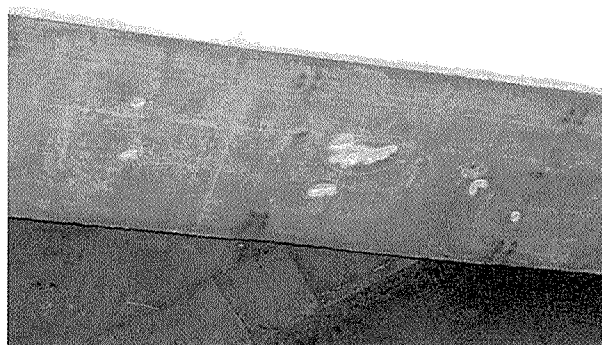
写真-2 コンクリートのはく落箇所
