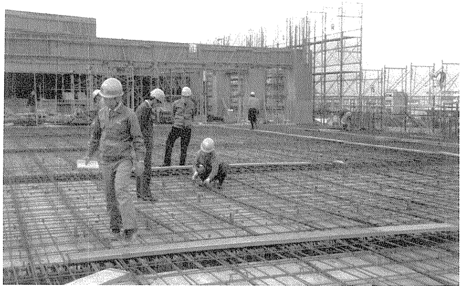
写真-2 建設中の郵政省大阪倉庫のアンボンドPCフラットスラブ
