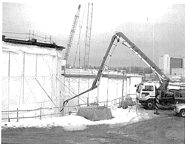
写真-6 冬期養生設備状況
