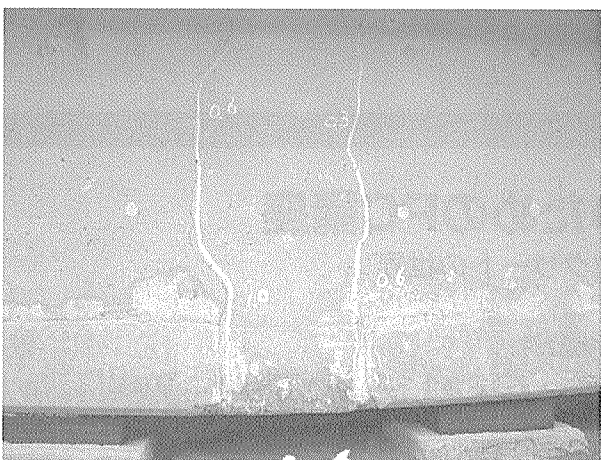
写真 - 7 連結横桁部ひび割れ
