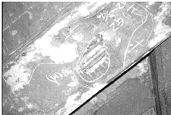
写真 - 1 コンクリートのはく離
