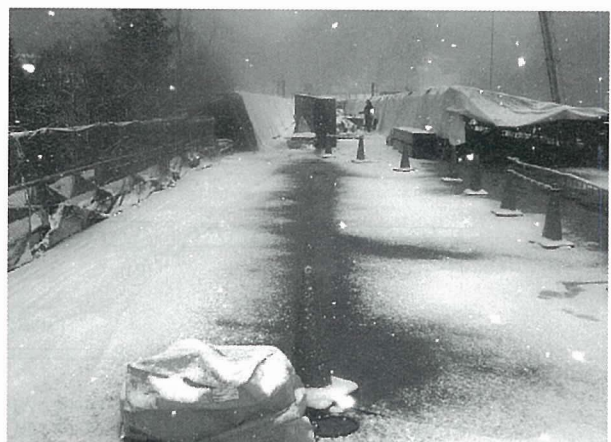
写真-5 電熱線による雪融け
