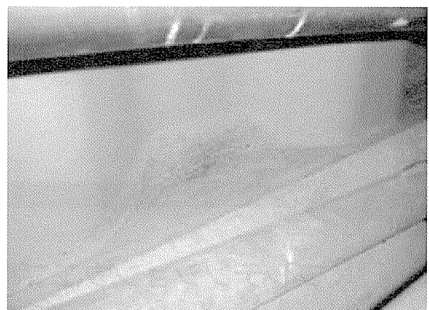
写真 - 6 箱桁内の滞水跡
