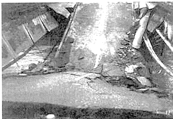
写真 - 1 Ynys - y - Gwas 橋の落橋 3)
