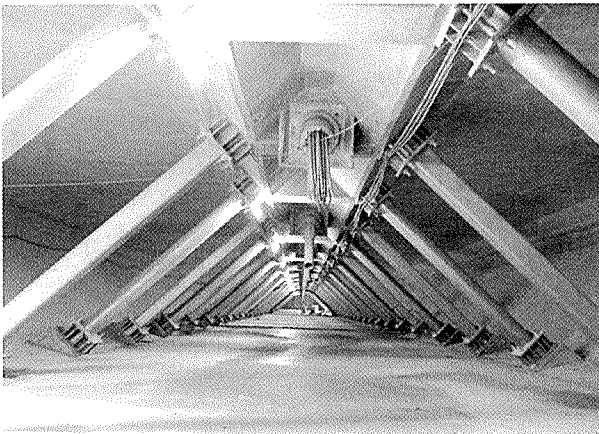
写真 - 2 鋼管ブレース
