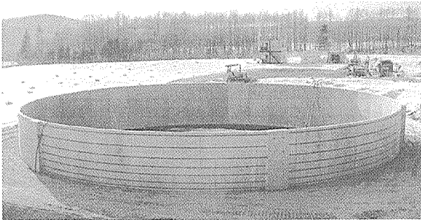
写真-4 スラリータンク
