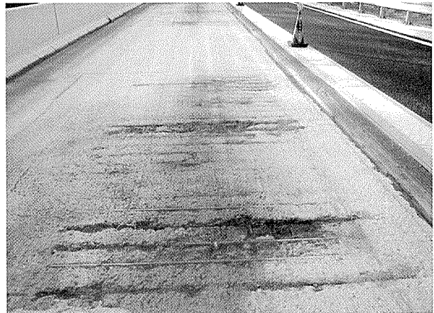
写真 - 1 床版コンクリート上面の損傷状況
