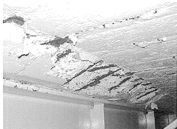
写真 - 2 床版コンクリート下面の損傷状況
