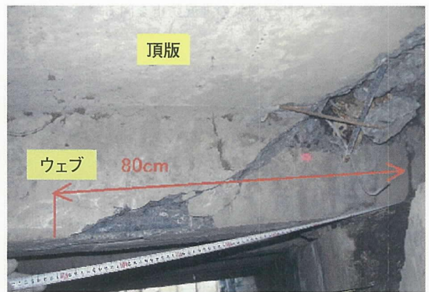
写真-1 道路橋の損傷事例
