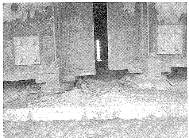
写真-1 支承の台座コンクリートの破損
