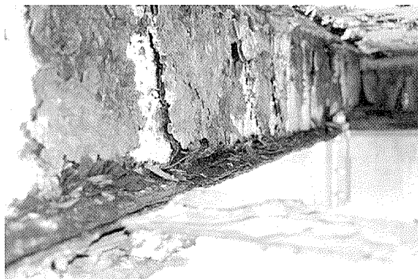
写真 - 6 研究に活用した腐食した鋼橋
